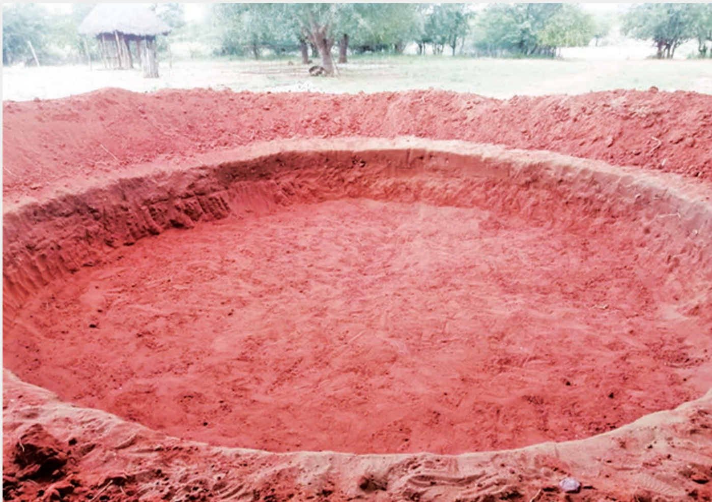
Legenda: Escavação do primeiro bloco de 10 cisternas de enxurrada e passeio em Muzamane - Mapai
